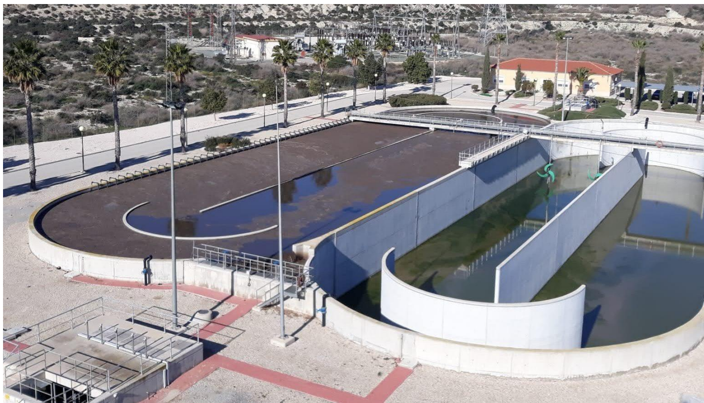
EDAR de Cieza (Murcia) – Reactor biológico
